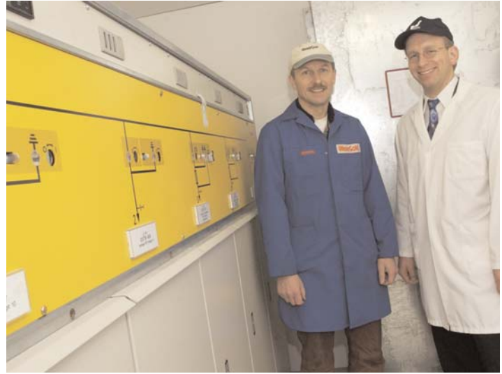
Uwe Patscher (links), Abteilungsleiter Produktionstechnik von WeserGold, und Helge Postler, Mitarbeiter der WSG, vor der neuen Schaltanlage bei WeserGold.
